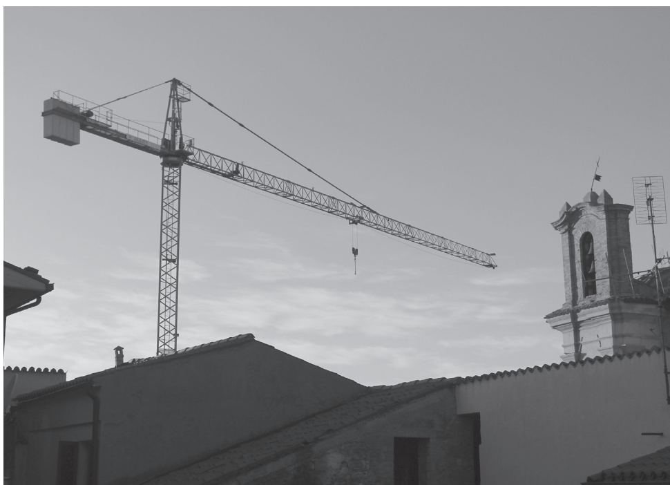
Fig. 6. Una gru all'opera per la ricostruzione del centro storico, nei pressi della chiesa di Santa Maria del Soccorso. Penna Sant'Andrea, 31 gennaio 2023 (foto di Gianfranco Spitilli).
